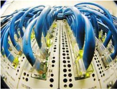
Paneles de parcheo (patch panel)
